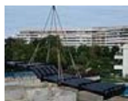
Puits canadiens / ventilations
