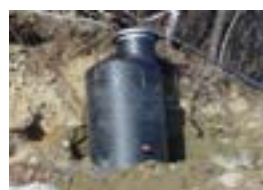
Chambres eau potable
