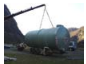
Réservoirs eau potable
