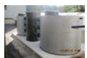
Fosses de pompage
