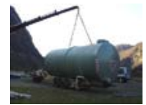
Réservoirs eau potable
