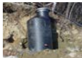
Chambres eau potable
